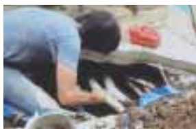
lekkage onder terras verhelpen
